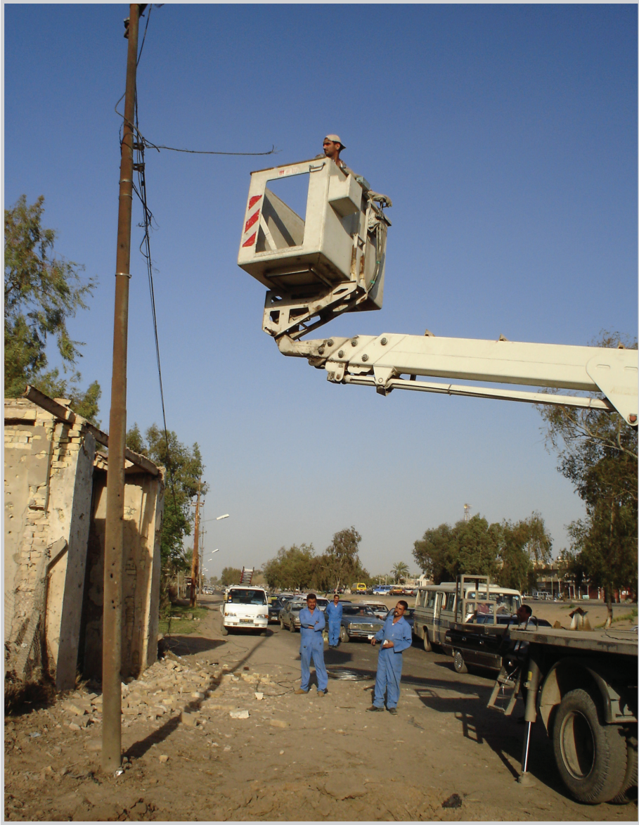
رفع تجاوزات كهربائية
