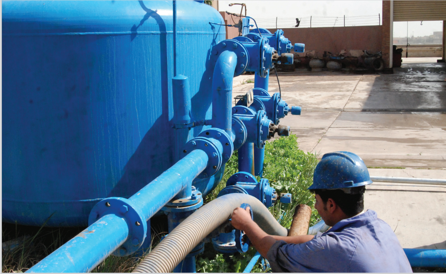
محطة تصفية مياه
