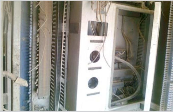
كابينة كهرباء لإحدى العربات يراد تأهيلها
