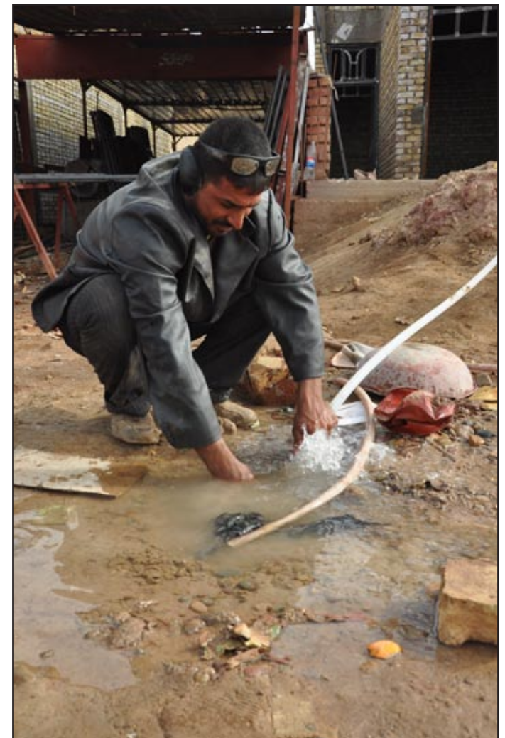
اتحاد مياه المجاري مع مياه الشرب
