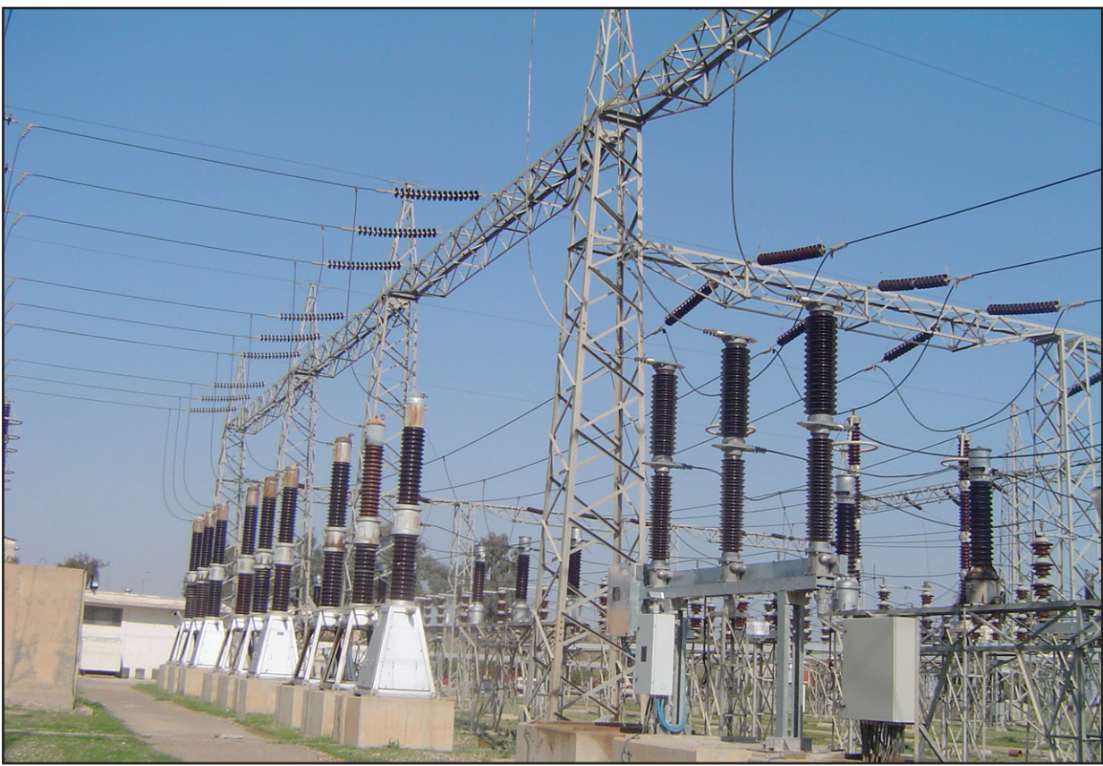
محطة كهرباء ( ارشيف)
