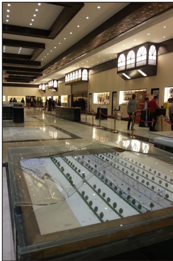
لمحة توضع انهيار جزء السقف الثانوي لاحدى قاعات المعرض فيما يظهر في الصورة الثانية تحطم زجاج احد العارضات .. (خاص بالمدى)
