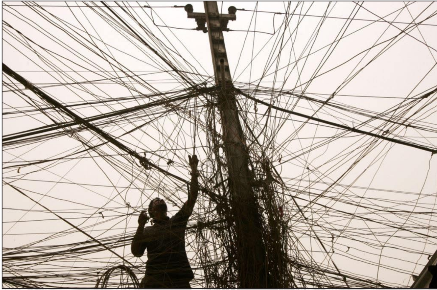
اسلاك كهرباء المولدات متشابكة
