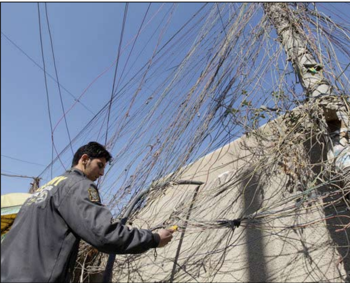
اسلاك لنقل الكهرباء من مولدة مناطقيّة - ارشيف
