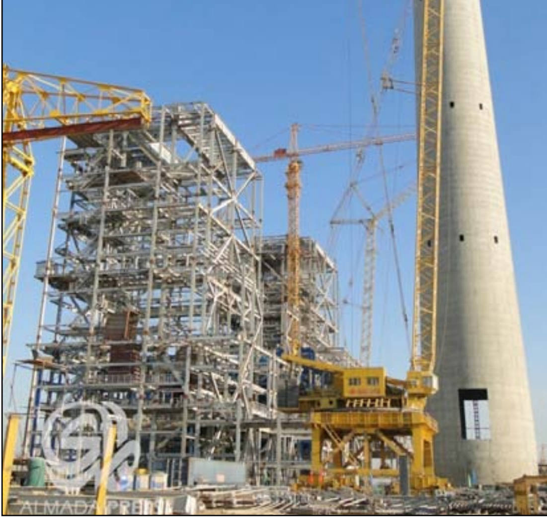
محطة كهرباء، واسط الحارثية
