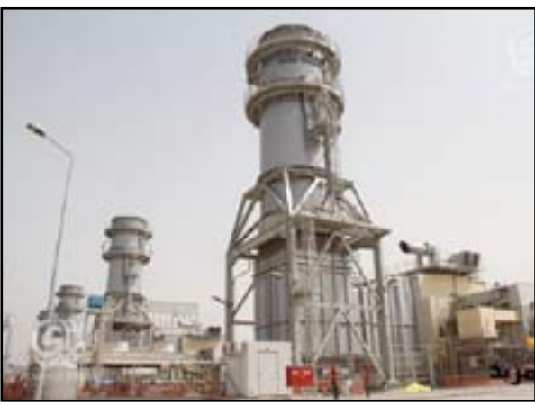
محطة كهرباء النجبية في محافظة البصرة
