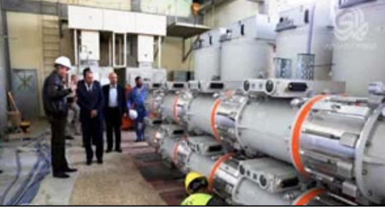
محطة قدرة في محطة كهرباء شمال الناصرية
