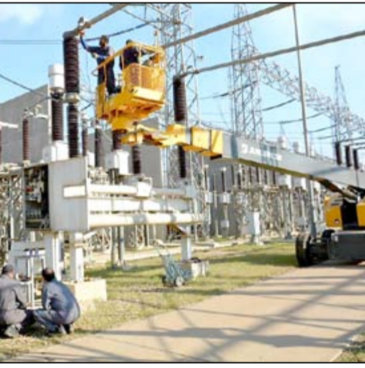
محطة بابل الكهربائية.. (خاص بالمدى)
