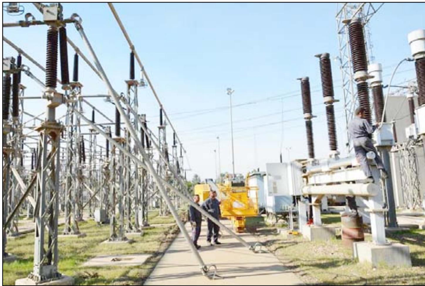
محطة لتوزيع الكهرباء في جنوب بغداد.. ارسيف
