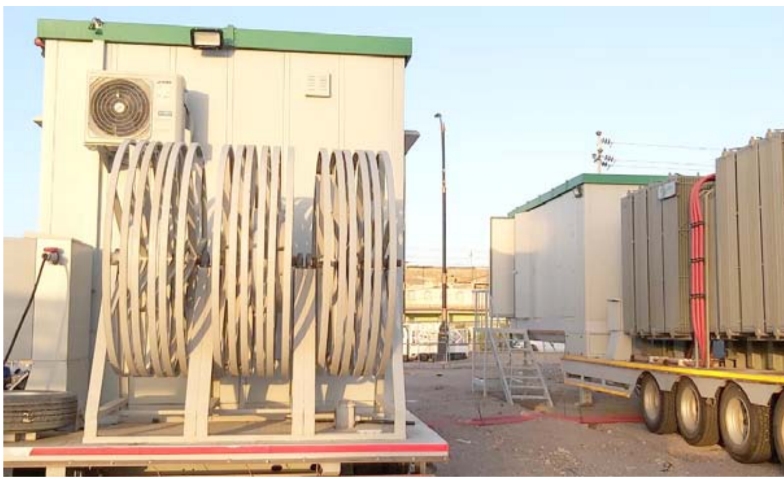
محطة كهرباء في الأنبار
