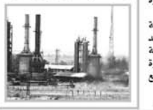
محطة بيجي الكهربائية
