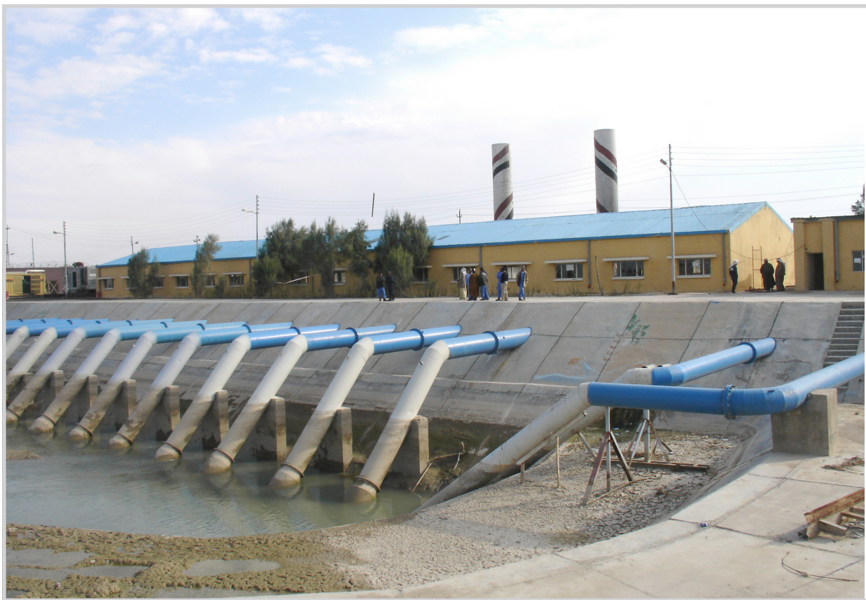
أحد مشاريع محطات الماء الصالح للشرب
