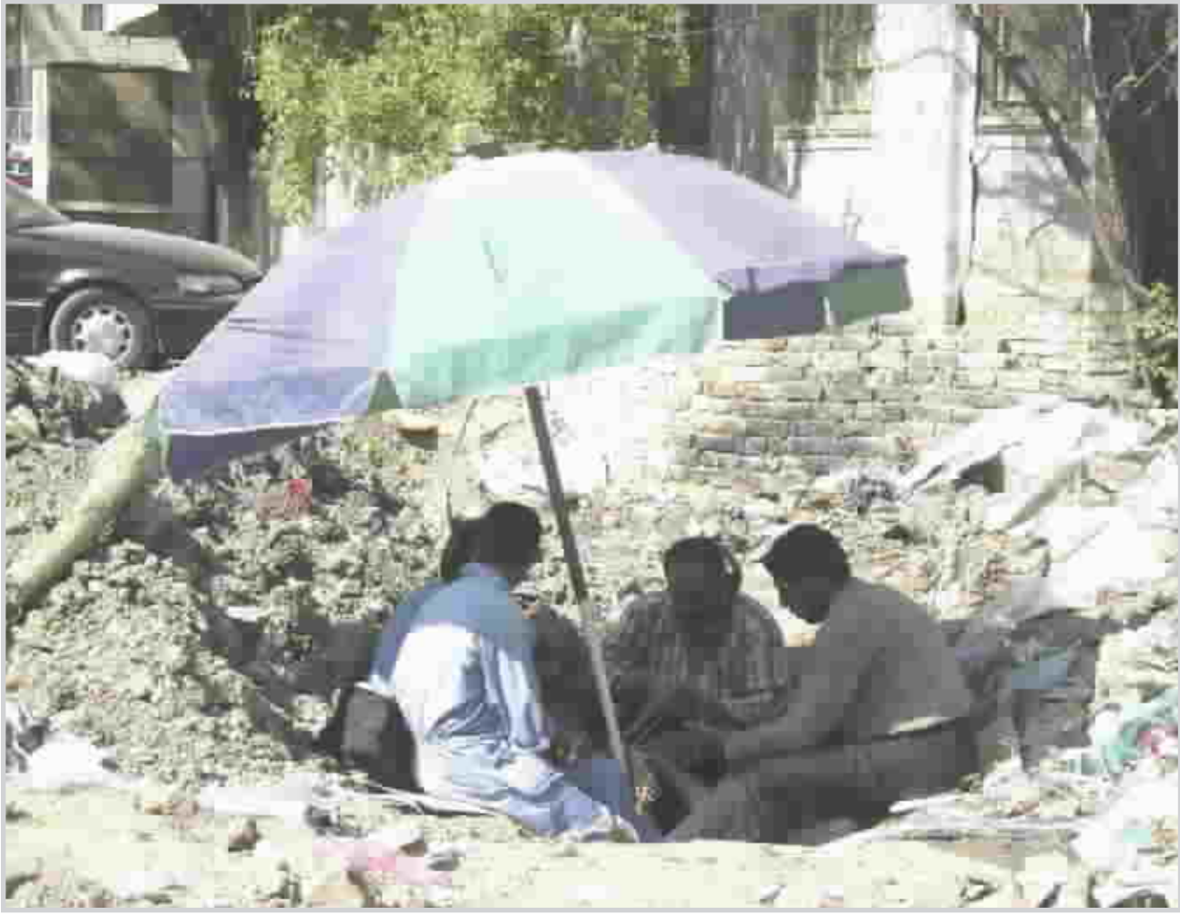
مفرزة تصليح كيبيلات الهاتف اثناء عملها في أحد احياء بغداد... تصوير: نهاد المزوي
